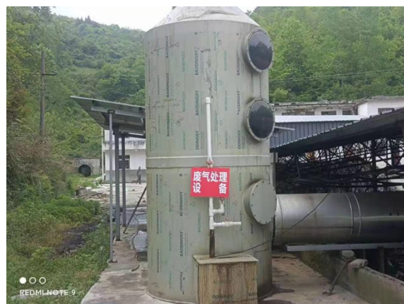
图4-6 废气处理设施
