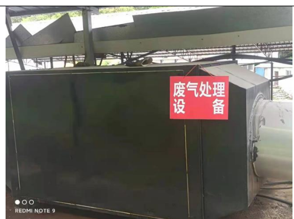
图4-5 废气处理设施
