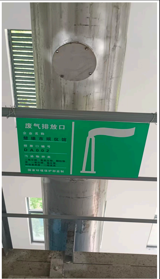
DA002 排气筒标识标牌及监测孔
