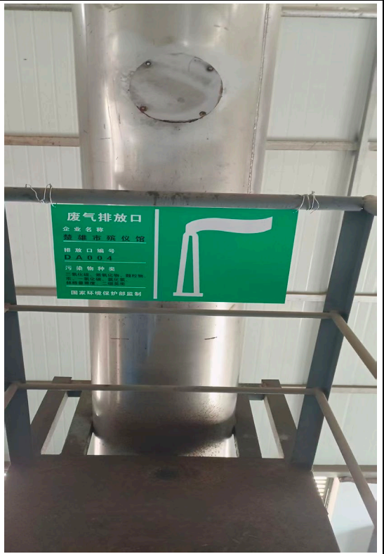
DA004 排气筒标识标牌及监测孔
