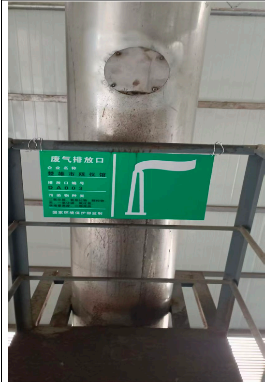
DA003 排气筒标识标牌及监测孔
