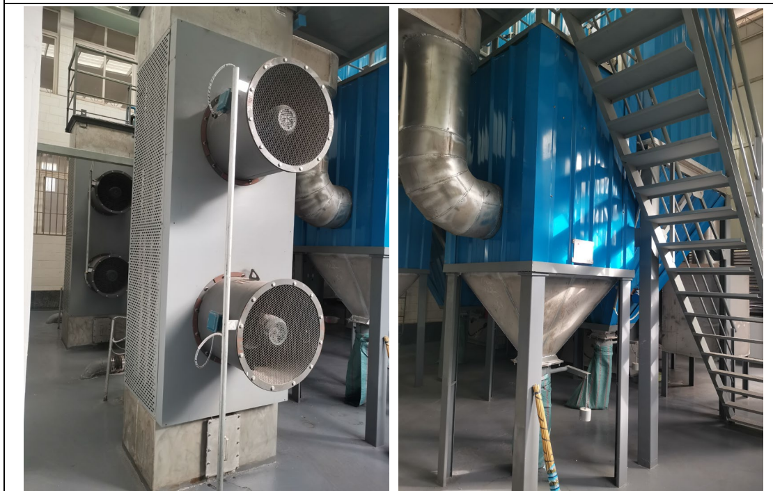
火化机废气处理设施
