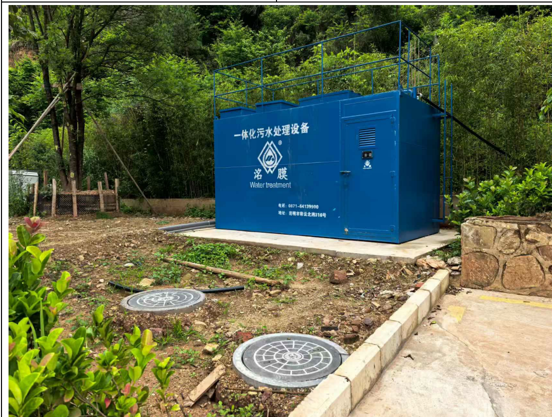
殡葬区一体化污水处理设施及地埋式回用水罐
