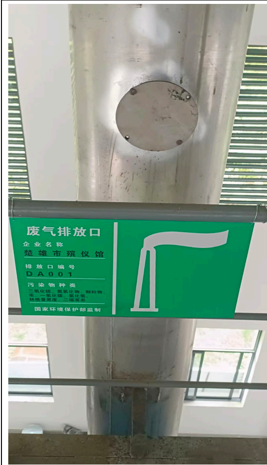
DA001 排气筒标识标牌及监测孔
