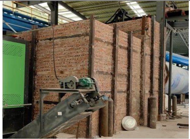
2#生产线沉降室
