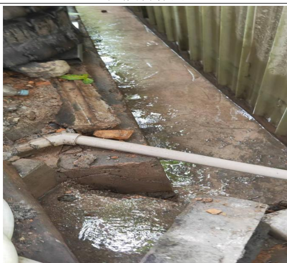
雨水沟与事故水池排导沟切换分离处
