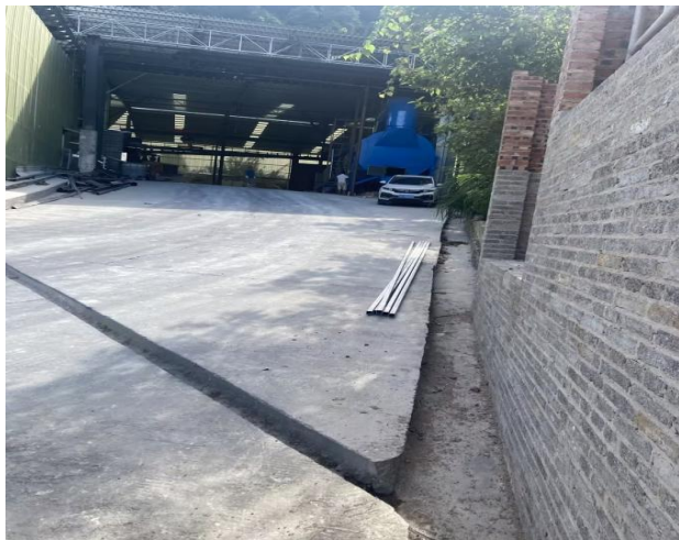
厂区雨水导排水沟
