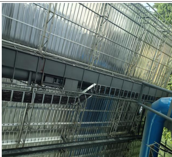
2#生产线输送管道
