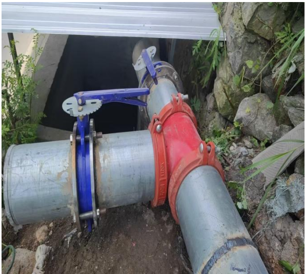
初期雨水池进口切换阀
