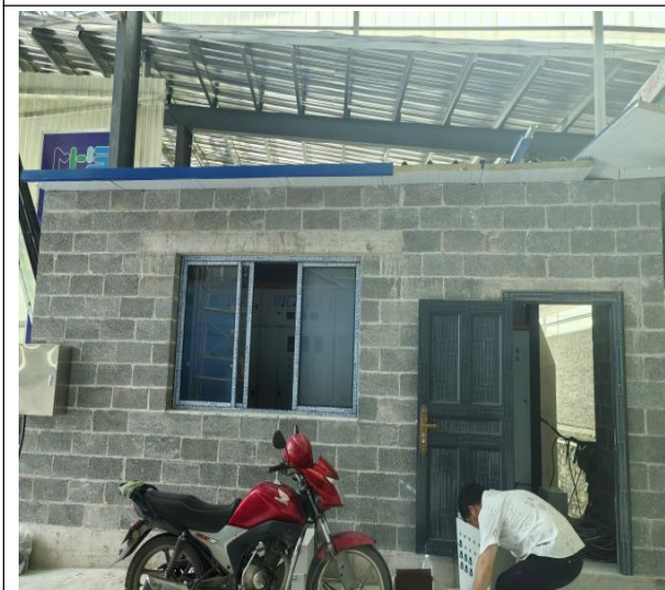
2#生产线配电房
