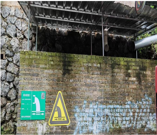
初期雨水收集沉淀池
