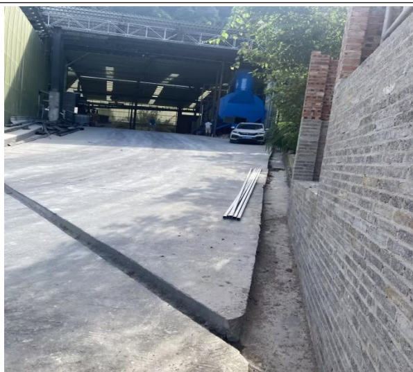
厂区雨水导排水沟
