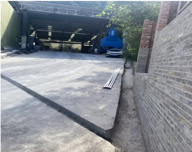
厂区雨水导排水沟
