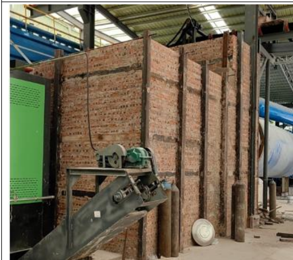
2#生产线沉降室
