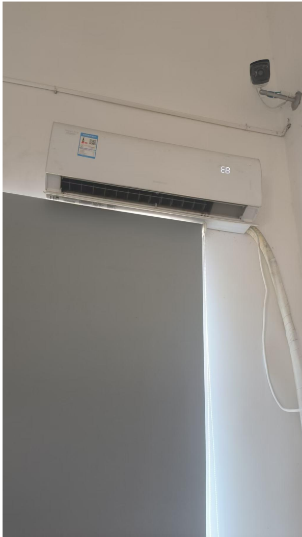
站房监控、空调
