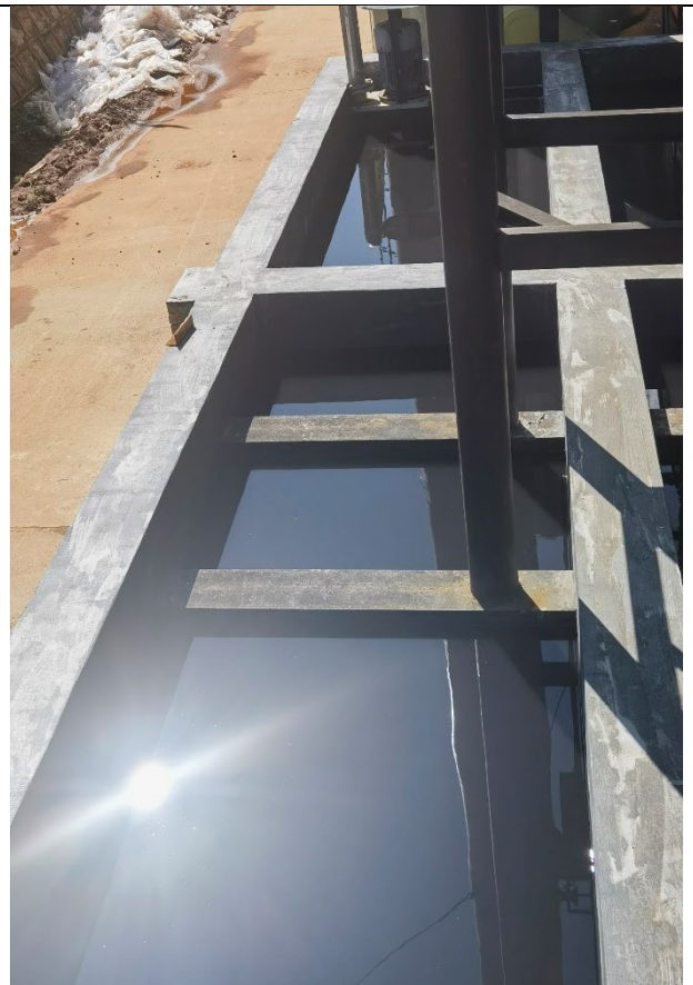
脱硫水膜除尘循环水池
