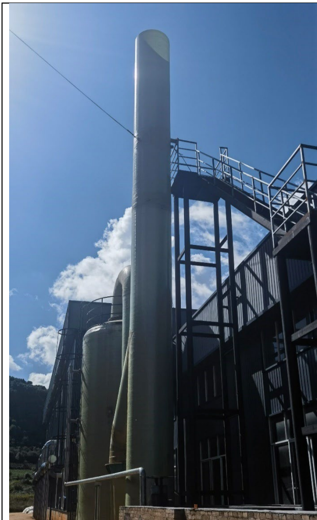
脱硫水膜除尘器排气筒及采样平台
