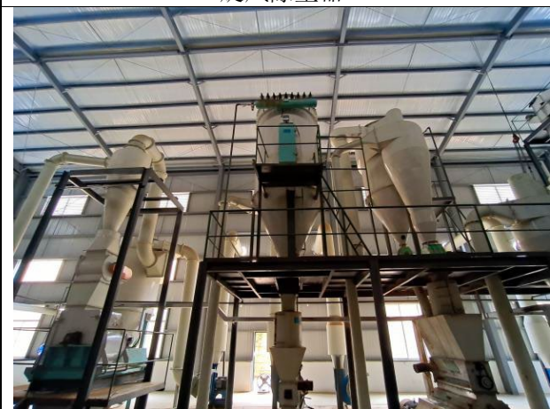
生产车间布袋式除尘器
