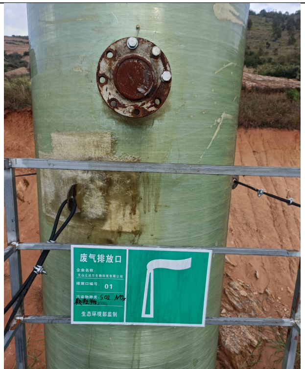
脱硫水膜除尘器排气筒监测孔及标识标牌
