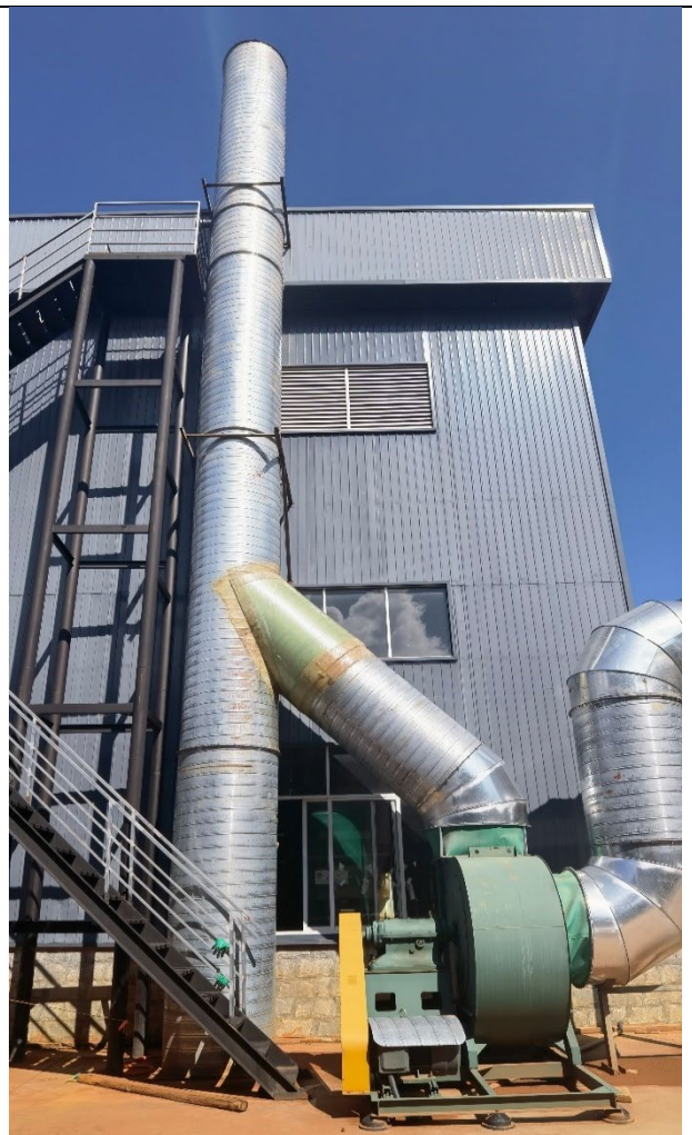
生产车间布袋式除尘器排气筒及采样平台
