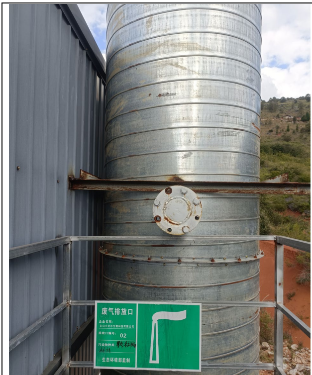
生产车间布袋式除尘器排气筒监测孔及标识标牌
