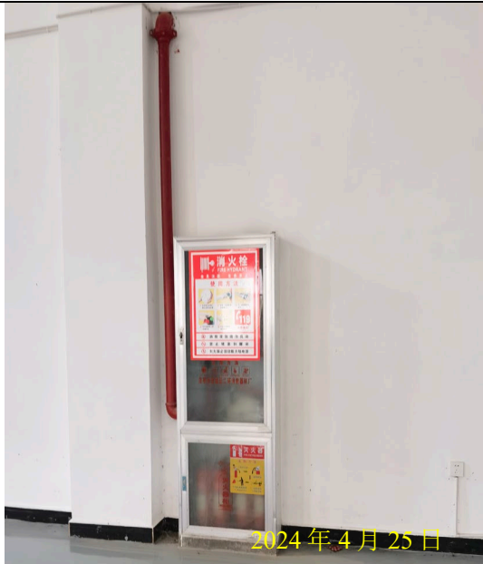
消防栓及灭火器箱
