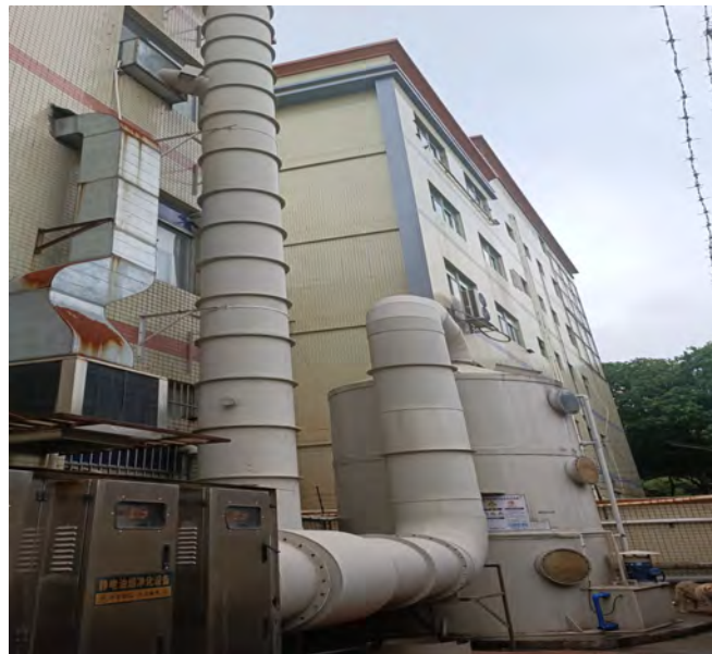
焊锡废气处理设施
