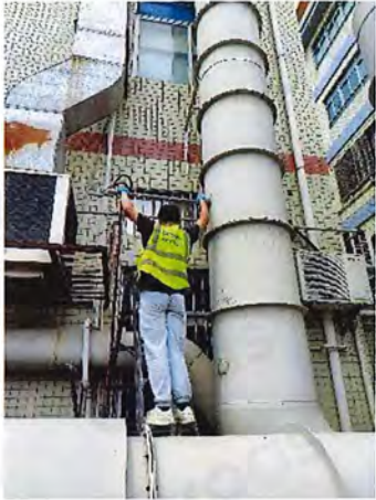
焊锡有组织废气处理前采样口 7#
