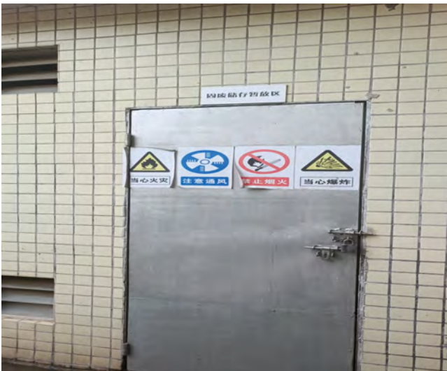
危废仓外部照片
