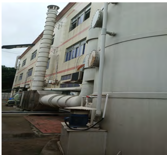
焊锡废气处理设施
