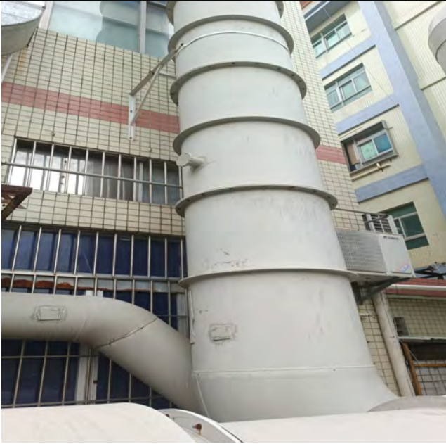
焊锡废气处理设施采样口
