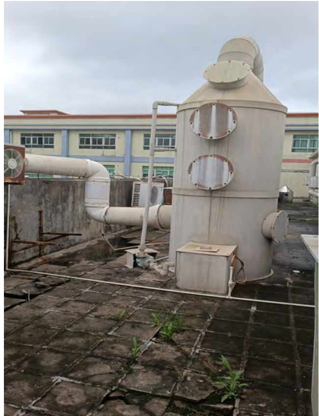
检验废气处理设施
