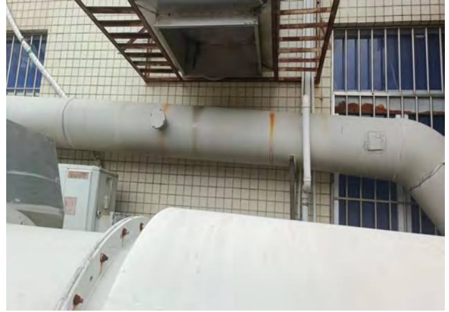
焊锡废气处理设施采样口
