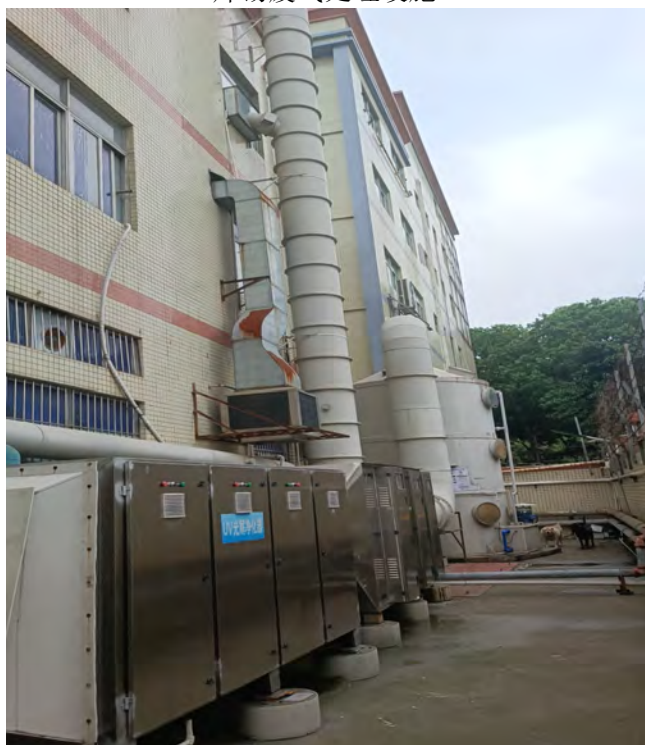
焊锡废气处理设施
