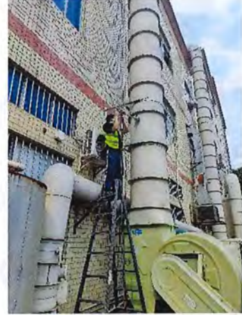
焊锡有组织废气处理前采样口 9#
