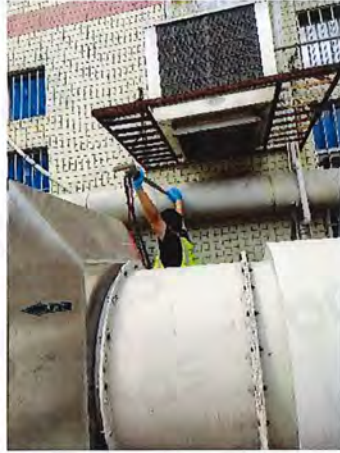
焊锡有组织废气处理前采样口 8#
