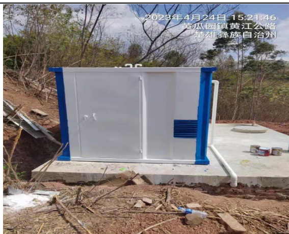
一体化污水处理设施
