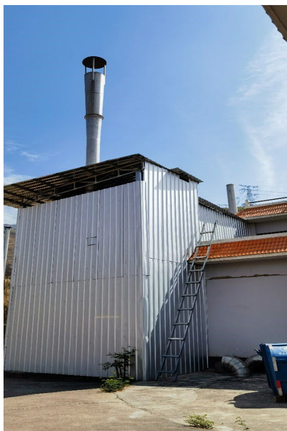
火化废气排气筒
