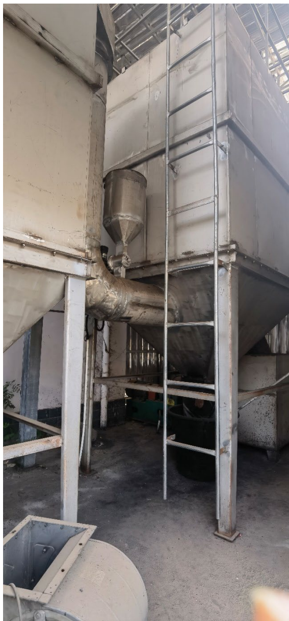
火化废气处理设施
