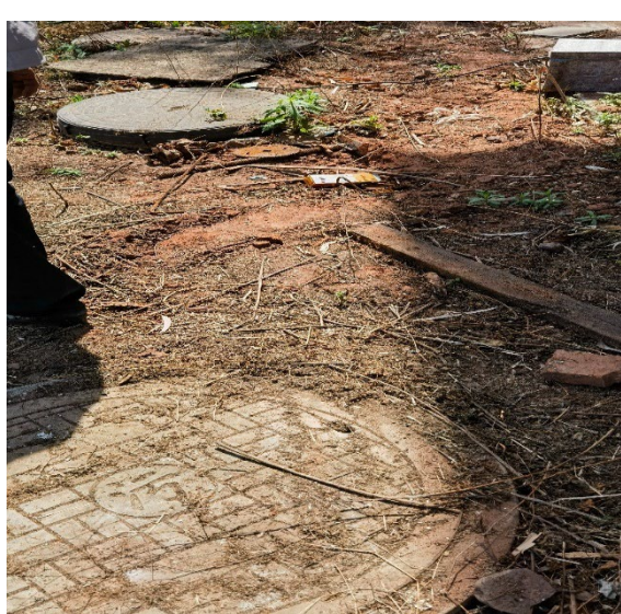
综合服务楼化粪池
