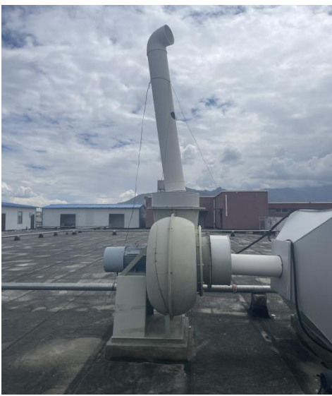
有组织废气排气筒
