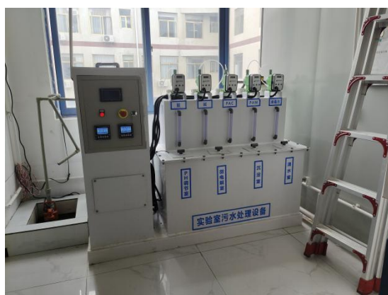
实验室污水处理设备
